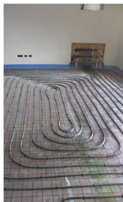
Le singole unità immobiliari sono dotate di impianti di climatizzazione a pannelli radianti, integrati nella pavimentazione mediante massetto anidritico (Montanari Costruzioni).
