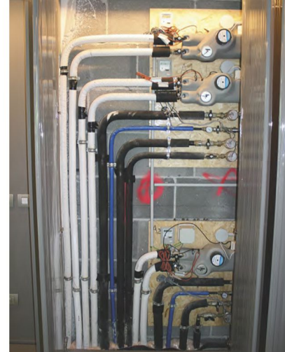
I montanti delle reti impiantistiche percorrono cavedi interni al blocco scala-elevatori, accessibili per le attività di manutenzione mediante semplice apertura delle ante metalliche (Montanari Costruzioni).
