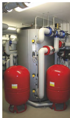
La produzione di ACS è affidata a un bollitore da 2.000 l, alimentato dal recupero termico attuato sulle pompe di calore destinate alla climatizzazione (Montanari Costruzioni).
