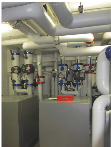
La centrale termofrigorifera è basata su 2 pompe di calore reversibili per riscaldamento e raffrescamento, collegate a un campo geotermico formato da 8 sonde verticali a circuito chiuso (Montanari Costruzioni).
